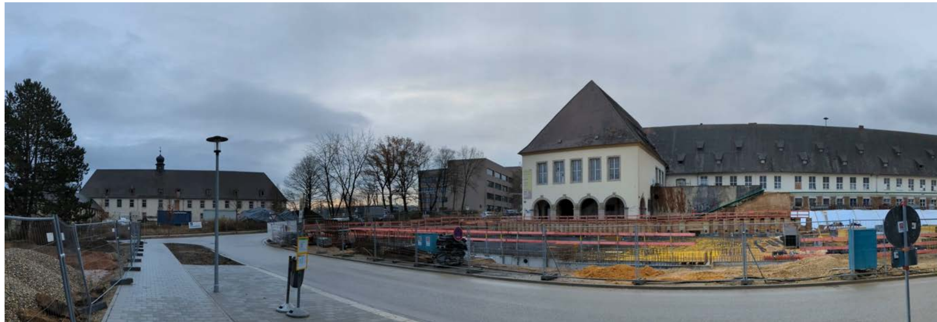
Abb. 25: Das ehem. Stabsgebäude (links) und Wirtschaftsgebäude (rechts) der Nibelungenkaserne während der Umbauarbeiten 2021.
